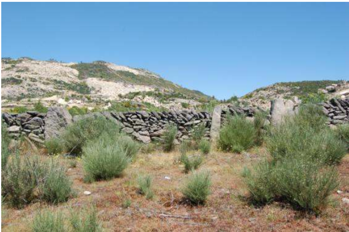
Fig. 10. Ocorrência 3 – Muro da Vinha.
